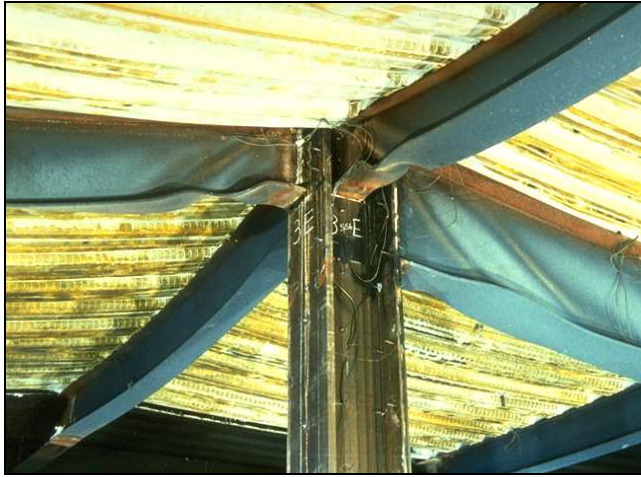
Figura 2.20 Capitel en el que se pueden ver las vigas con pandeo
