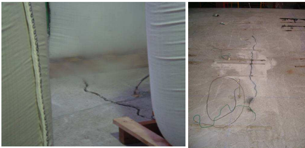
(a) Estado de las grietas en la parte central del forjado
