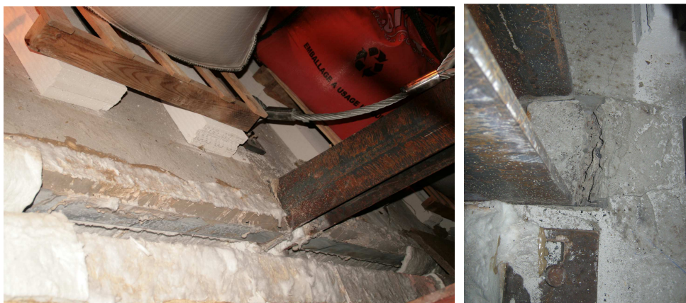
Figura 7.42 Agrietamiento del hormigón en torno a los pilares centrales
