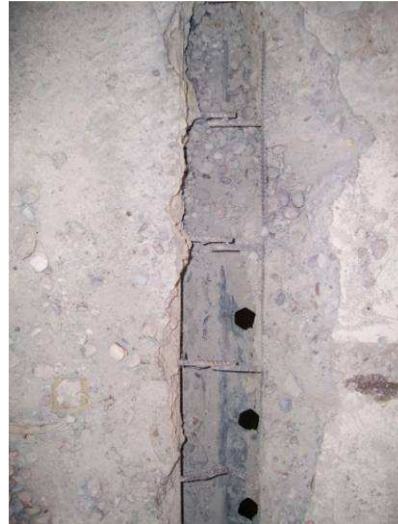
(b) Estado de la junta de armadura en el lugar de la grieta tras el enfriamiento
