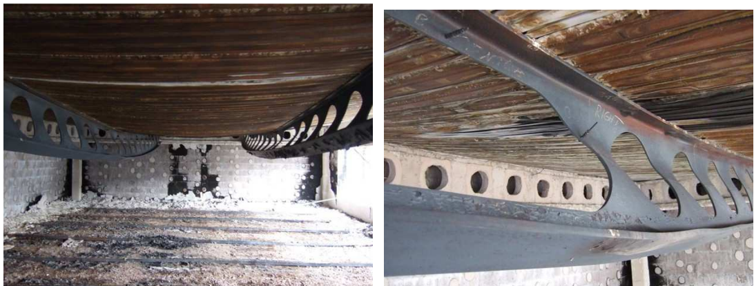
Figure 7.10 : Deformación del forjado/vigas desprotegidas posterior al incendio
