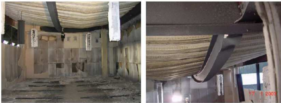
Figura 2.25 Vista del forjado después del ensayo
