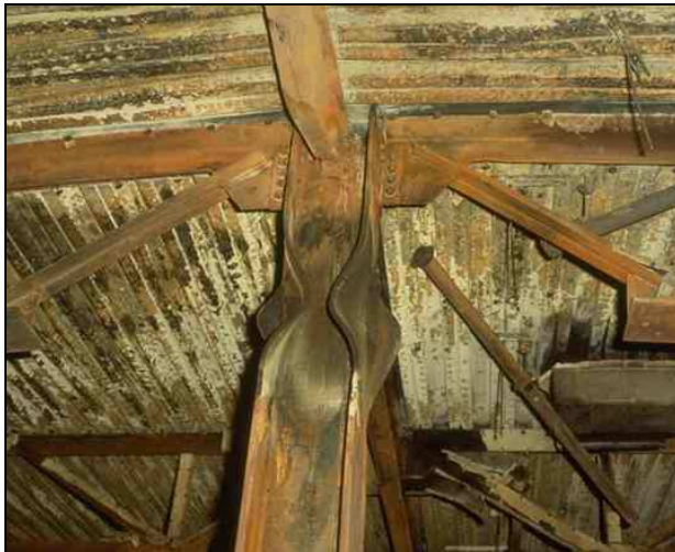
Figura 4.1 Pilar con pandeo y vigas deformadas en Broadgate
