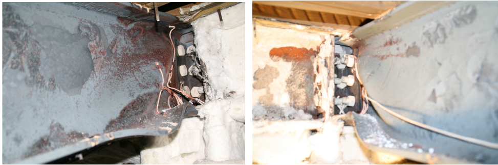
Figura 7.39 Pandeo local de vigas secundarias sin protección conectadas al pilar
