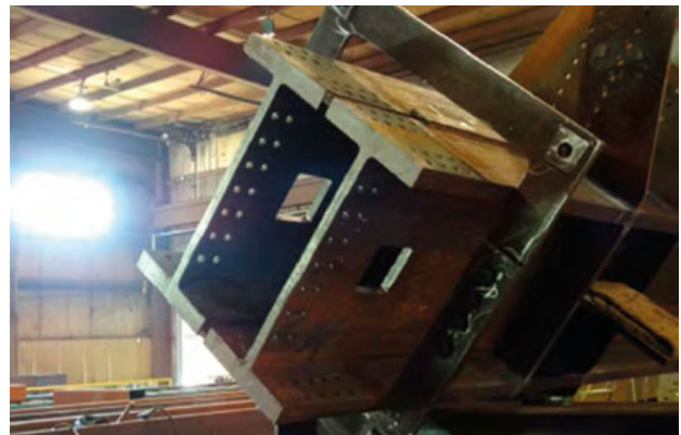
Deux profilés soudés ensemble Two heavy sections welded together Два тяжелых профиля, сваренных вместе
